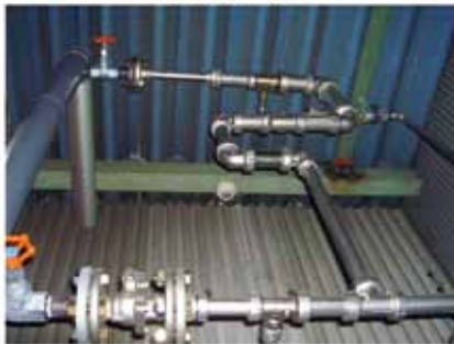
配管写真A
