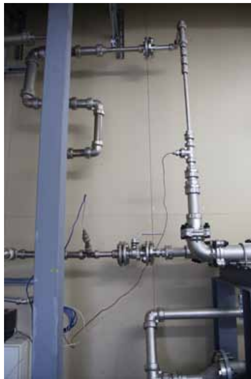
配管写真B
