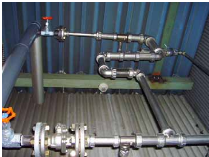
配管写真A
